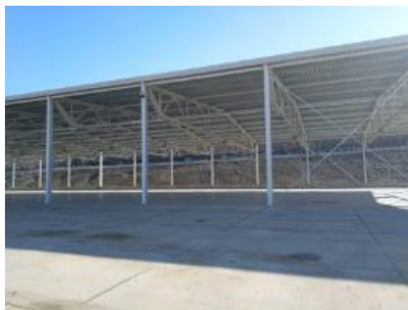
Stația TMB – zona de maturare
