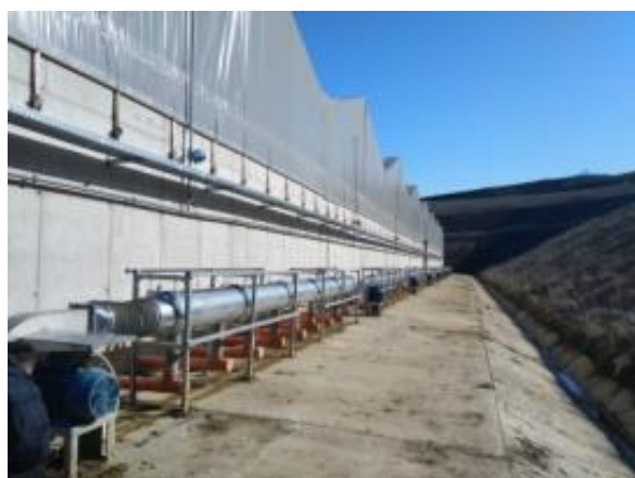
Stația TMB – sistem aerare
